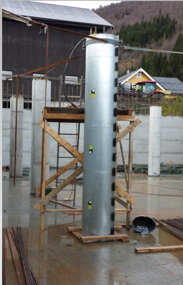
Landbruksbygg på Haukedalen i Sogn og Fjordane. Diameter Ø400mm. Høyde 4200mm.
