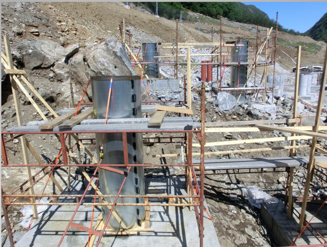
Trafostasjon Høyanger i Sogn. Diameter Ø800 og 1000mm.
