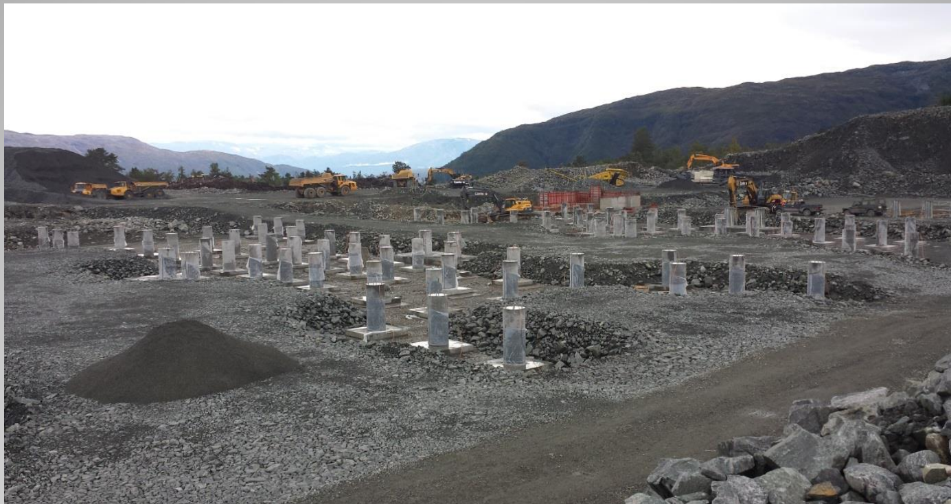
Trafostasjon Fardal i Sogn. Flere hundrede søyler.
