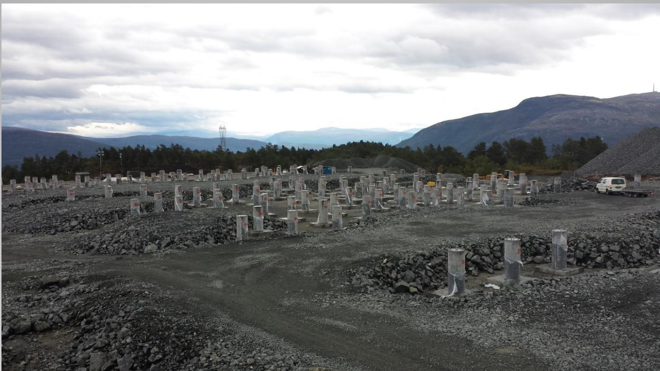
Trafostasjon Fardal i Sogn. Flere hundrede søyler.
