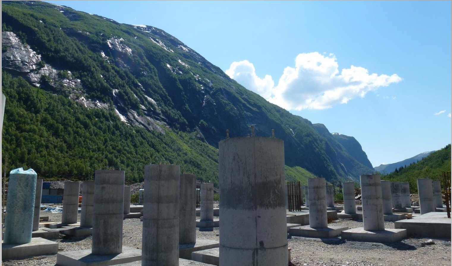
Trafostasjon Høyanger i Sogn. Diameter Ø800 og 1000mm.
